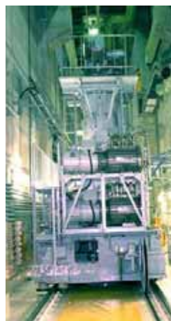
燃料交換設備
